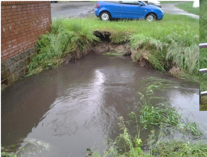
2016-05-30 10.08.49 Böschungsabbruch Einleitung E15 Steinstraße
